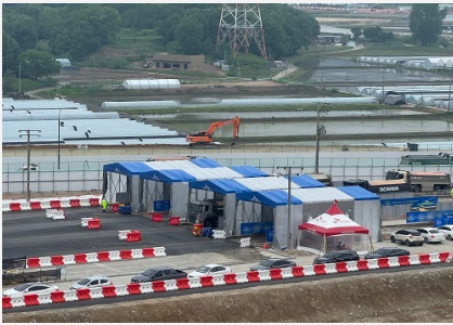
수조식과 자동식 세륜시설 직렬배치
